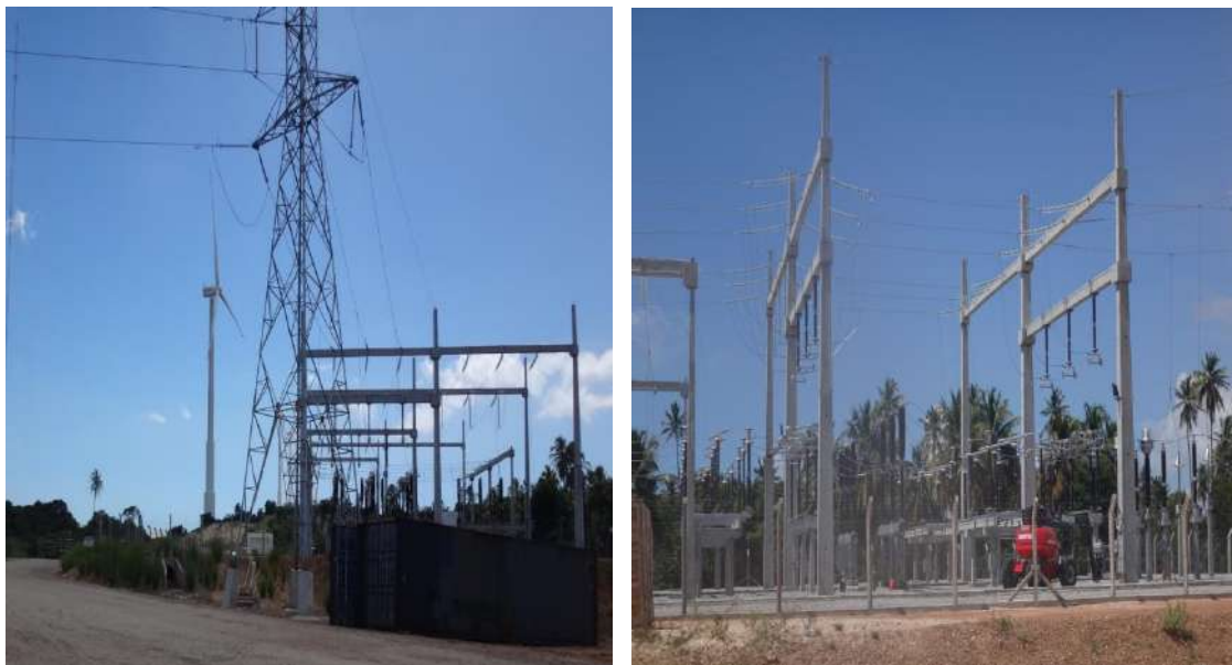
Figura 8: Serviços que envolvem eletricidade na central geradora eólica Andorinha
