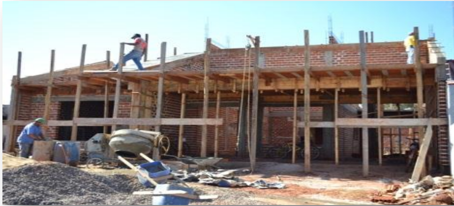
Figura 9: Trabalhadores em não conformidade com a NR-35
