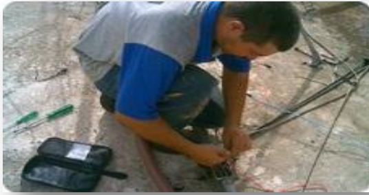
Figura 2: Eletricista de forma irregular
