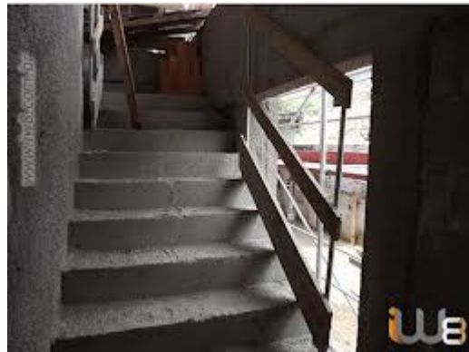
Figura 13: Proteção de Vão de Escada
