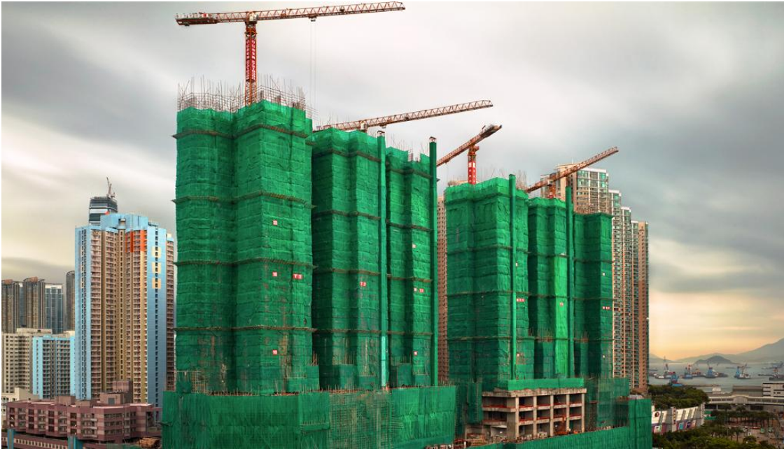
Figura 11: Redes de proteção
