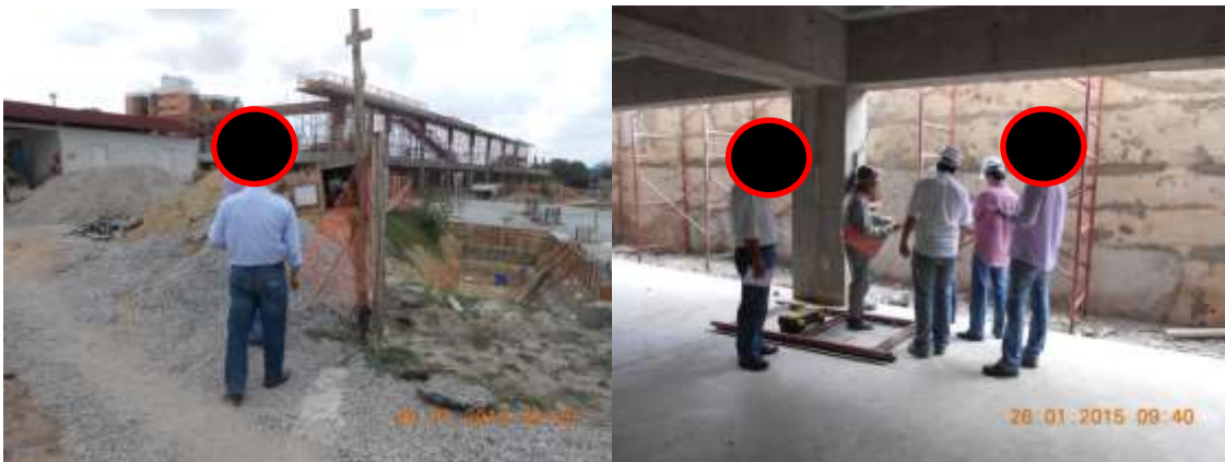
Figura 10. Fiscalização da SRTE/ MTE -CE- Instalações elétricas inadequadas.
