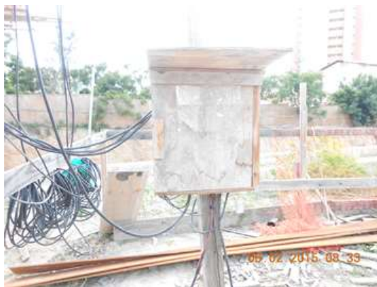
Figura 8. Quadro elétrico de madeira (em inconformidade)
