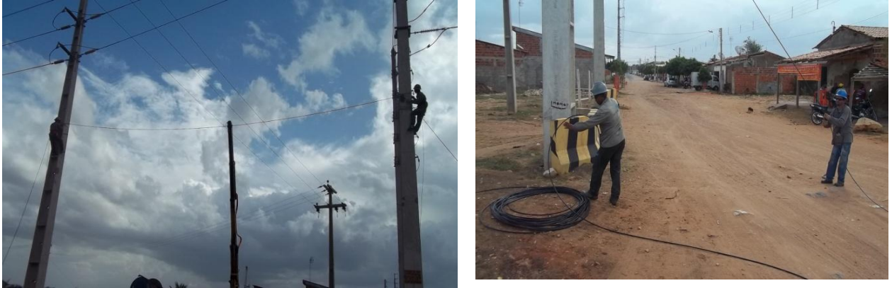
Figura 02. Lançamento de cabo telefônico aéreo realizado na cidade de Taparuaba-Ce. Fonte: Arquivo Master.
